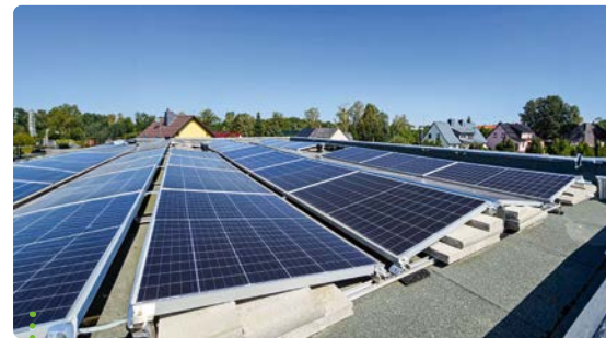
Strom vom Dach – die Photovoltaikanlage trägt maßgeblich zur Eigenstromerzeugung bei. Foto: AWO / Steve Nowotsch
