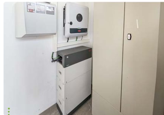
Energieunabhängigkeit: Im Falle eines Stromausfalls kann weiterhin auf gespeicherte Energie zugegriffen werden. Foto: AWO / Steve Nowotsch
